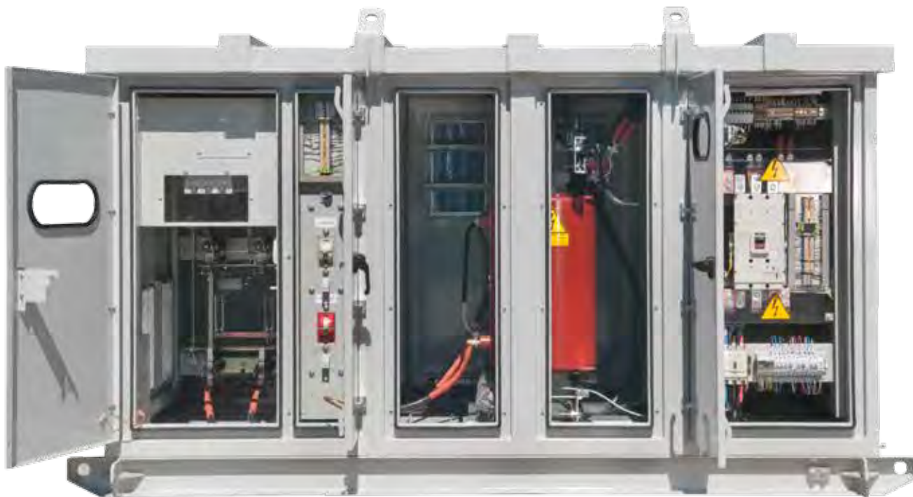
Subestación Interior Mina 500 kVA, 4.16 / 0.4 kV
